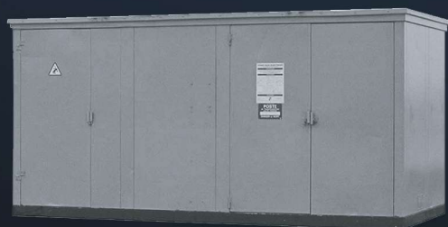
Tarif vert DE 250KVA À 2500KVA
